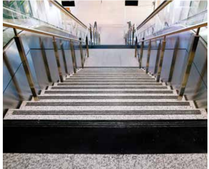
Exemple de mauvaise utilisation de nez de marche. Les marches de couleur pâle à nez de bandes noires créent un motif de marquage qui n'est pas bien perçu par des personnes vivant avec une perte de vision.
