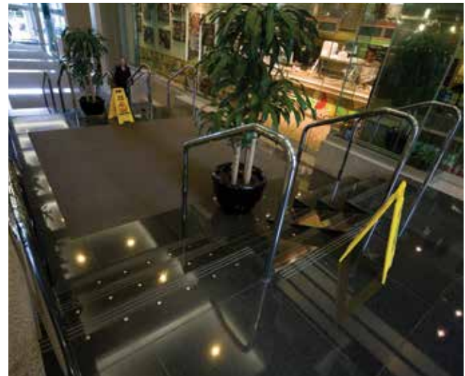
Exemple de mauvais design d'un escalier – marches noires sans couleur contrastante sur le nez.
